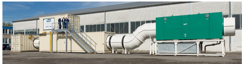
Bild 5: Werksaufbau der Schachtbewerterungsanlage für Schacht 2
