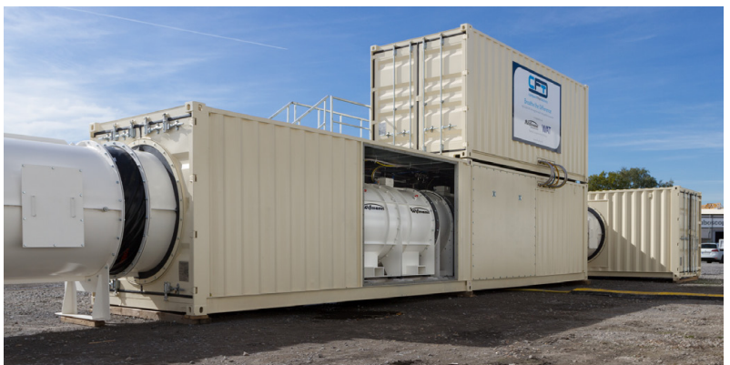
Bild 6: Geöffnete Revisionsöffnung des Lüftercontainers, dahinter Axialventilatoren
