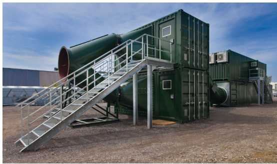
Bild 9: Werksaufbau aus einer weiteren Perspektive (im Vordergrund 2 Kühlcontainer mit jeweils 1.000-kW-Lamellenwetterkühler)
