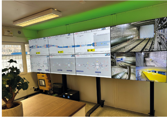
Bild 7: Zentraler Leitstand zur Anzeige aller Messdaten, zur Steuerung der Ventilatoren im Bauwerk und zur Darstellung der Personenortung
