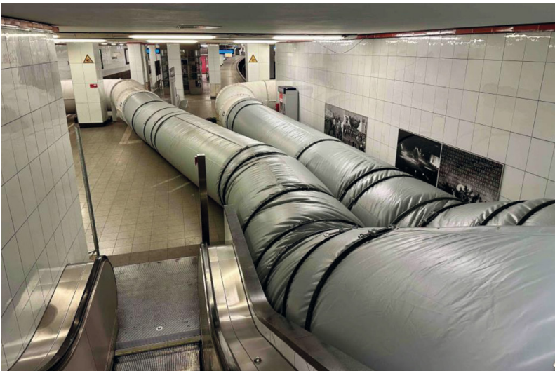
Bild 3: Lüttentour für aktive Entlüftung über einen Kamin im Bahnhof Potsdamer Platz
