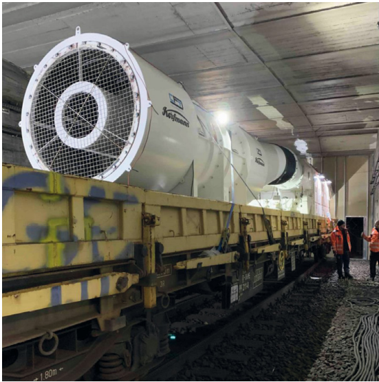
Bild 6: CFT-Trockenentstaubungsanlage mit Korfmann-Axialventilatoren zur Reinigung staubhaltiger Abwetter aus dem Baufeld
