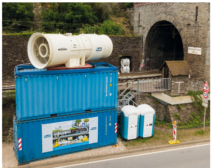
Fig. 2: Belüftungsanlage für Tunnelsanierung
