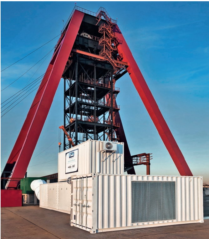
Рис. 7: Ввод в эксплуатацию шахтной вентиляционной системы для ствола 2 на руднике в Беларуси.
