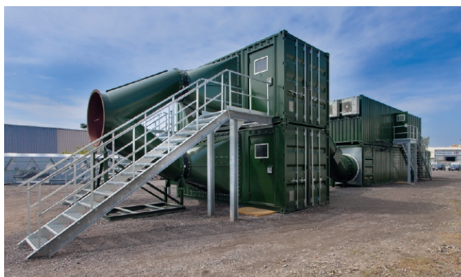
Рис. 9: Заводская сборка с другого ракурса. (на переднем плане 2 контейнера охлаждения каждый с пластинчатым охладителем 1.000 кВт)
