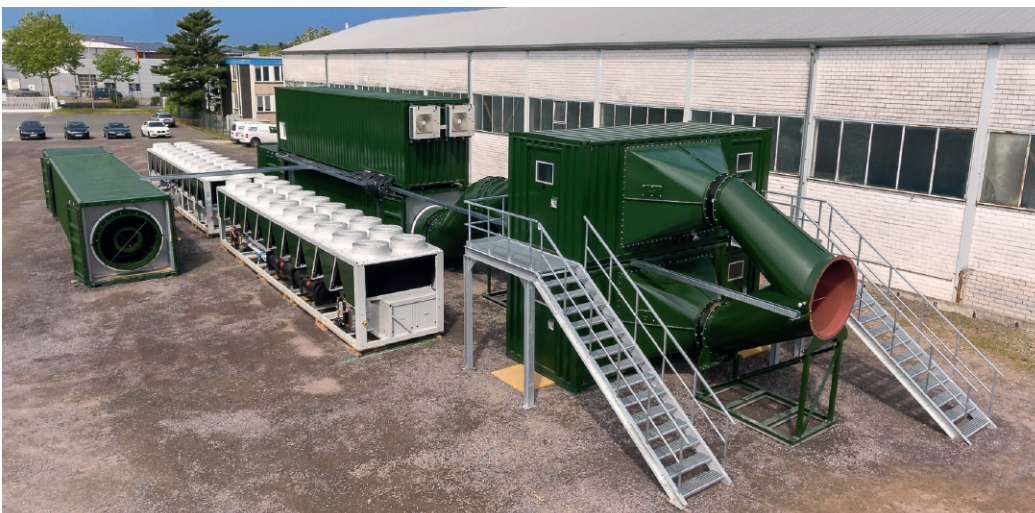
Рис. 8: Заводская сборка шахтной вентиляционной системы для клетьевого ствола. (слева направо: Контейнер для отсасывающего вентилятора, 2 водоохлаждающие машины с воздушным охлаждением, контейнер для подающего вентилятора с надстроенным контейнером E-House и 2 контейнера охлаждения друг над другом)
