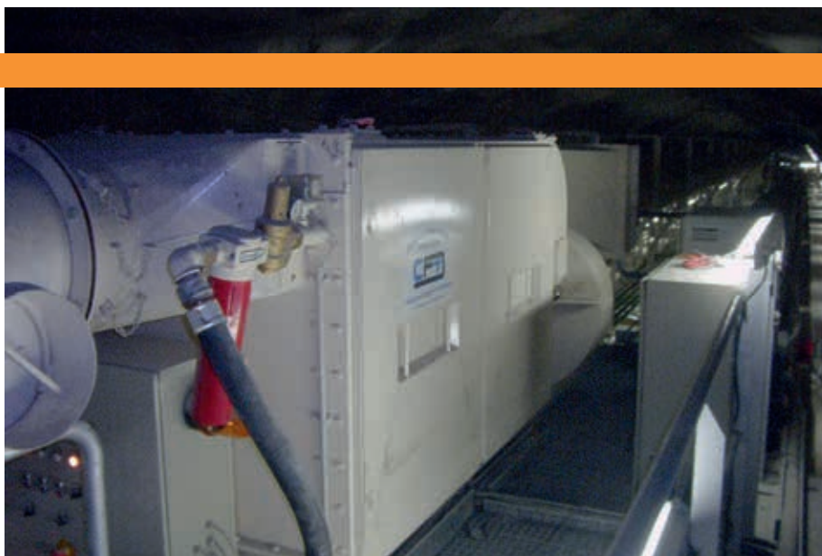
■ CFT Trockenentstauber Typ HTKS 1/250-R mit Radialventilator zur TBM-Entstaubung in der Erkundungsphase. (Bilder: zVg)
