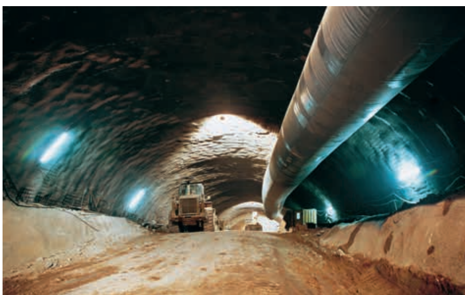
■ Schauenburg Flexadux Lutte Typ A (Antistatisch) mit Korfmann Ventilator im Gotthard-Basistunnel.
