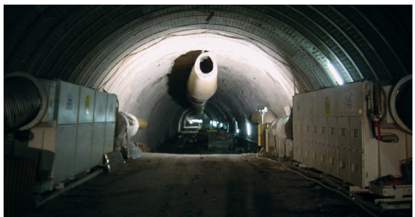
Bild 3: Rückblick von der Ortsbrust in Richtung Tunnel auf die Frischluftlutte und die Absaugeinrichtungen
