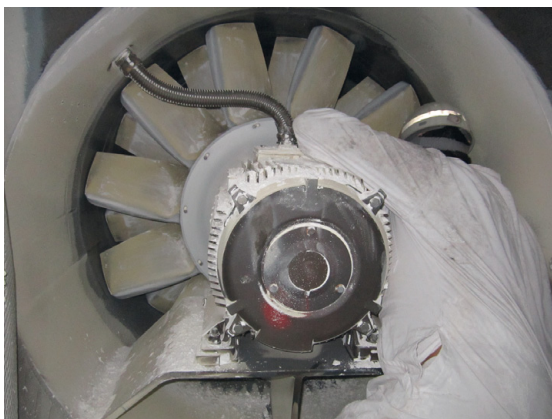
Bild 10: Durch Salzpartikel aus den Wetter beanspruchter Lüfter
