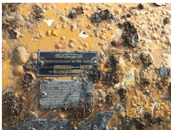
Bild 17: Oberflächenkorrosion durch Feuchtigkeit und salzige Luft
