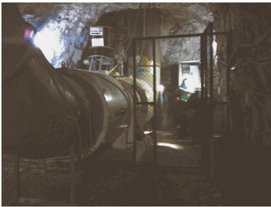
Fig. 13: Anhydrite mine – fan position
