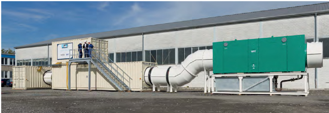
Bild 1: Schachtbewetterungsanlage „Slavkali“ in Weißrussland
