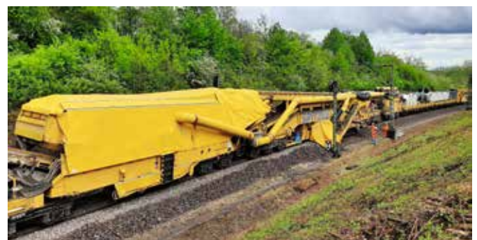
Bild 6 Entstaubungssystem für Schnellfahrstrecke 4080 Dust collection system for high-speed line 4080
