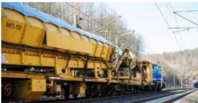
Bild 5 Beispiel Einhausung der Materialförder- und Silowagen Example of housing of material conveyor and hopper units
